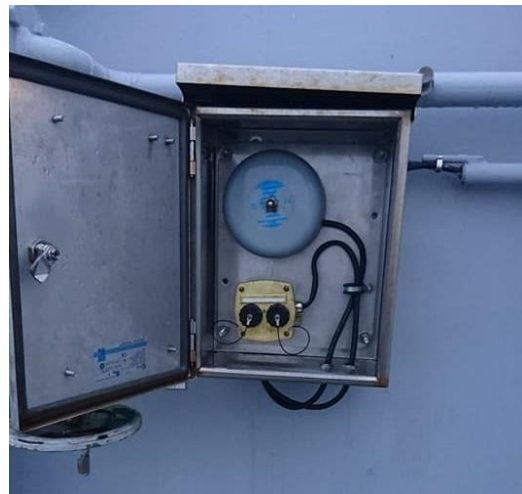
Bilde 5: Koblingsskap for samband (ved skyteposisjon)
