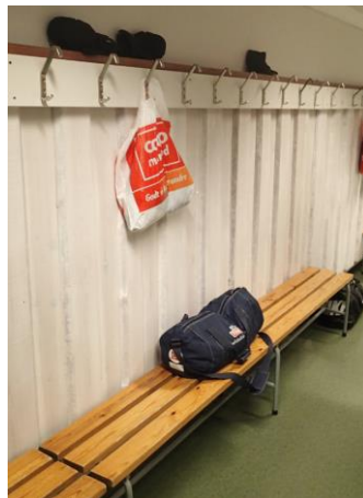
Brennbar trekledning i rømningsvei.
