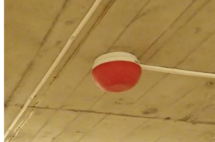
Tildekket røykdetektor på rom 08 Vaktmester.
