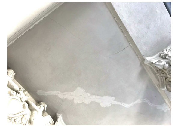
2. Fuktskade på himling over innebygd balkong 2.etg
