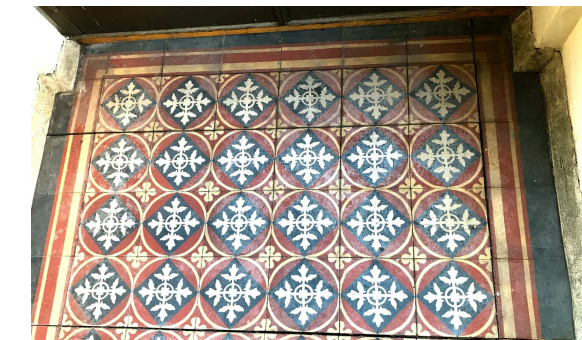
6. Fuktskade på gulvet over innebygd balkong 1.etg
