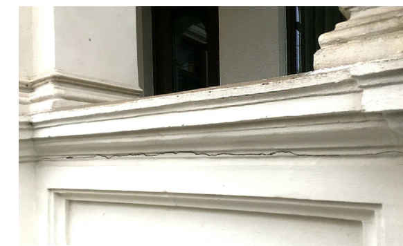
7. Avskalling av puss
