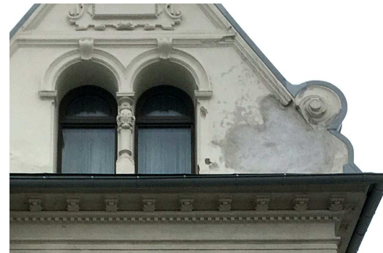
3. Midletidig utbedring av frotskade
