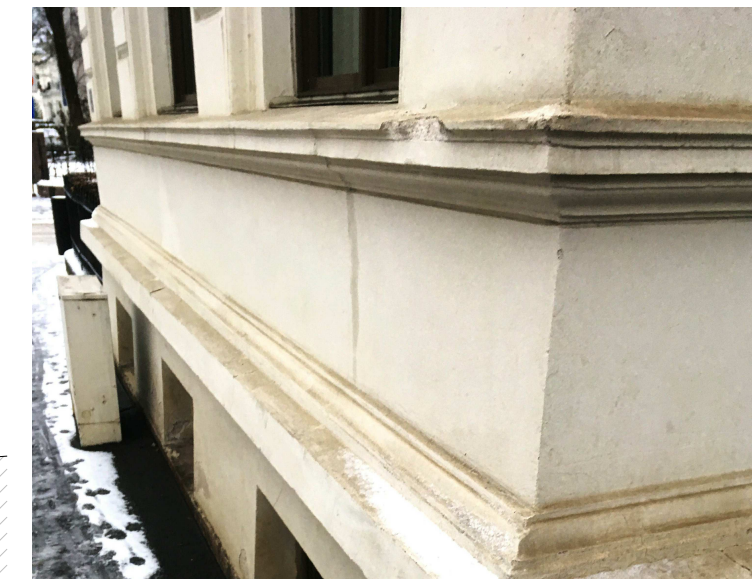
5. Frost/fukt skade på trekning
