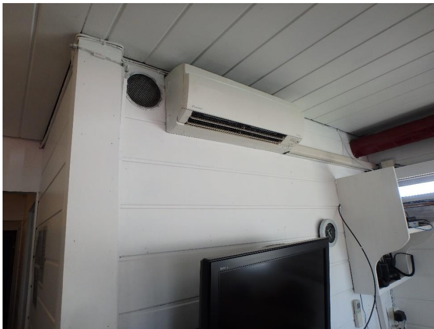
Figur 6 Varmepumpe med HFK-gass
