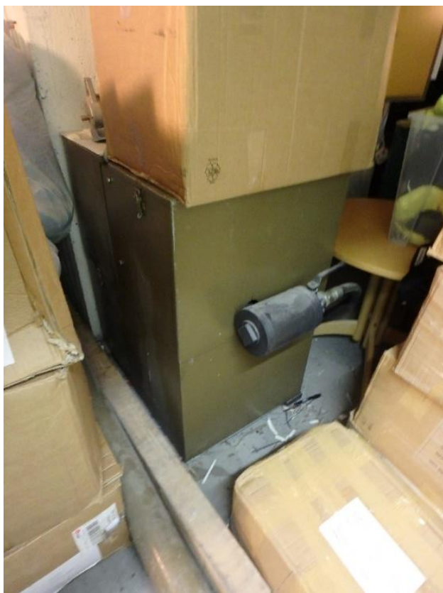
Figur 12 Heisens oljetank står i heismaskinrommet i 1. etasje
