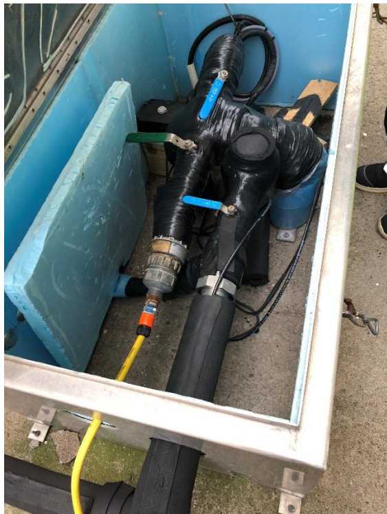
Figur 8 Frittstående pumpekasse på kaia er isolert med XPS-plater med HKFK-gasser
