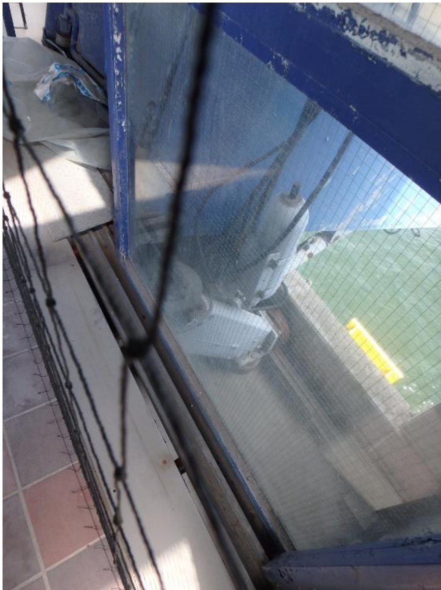
Figur 13 Oljehydraulikkaggregat i 3. etasje
