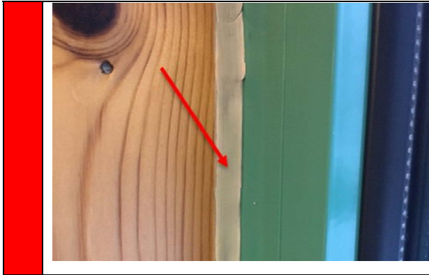
Figur 5 Grå fuge mellom vindu og utforing.
