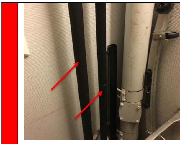
Figur 8 Neopren cellegummi på varmerør i bøttekott.
