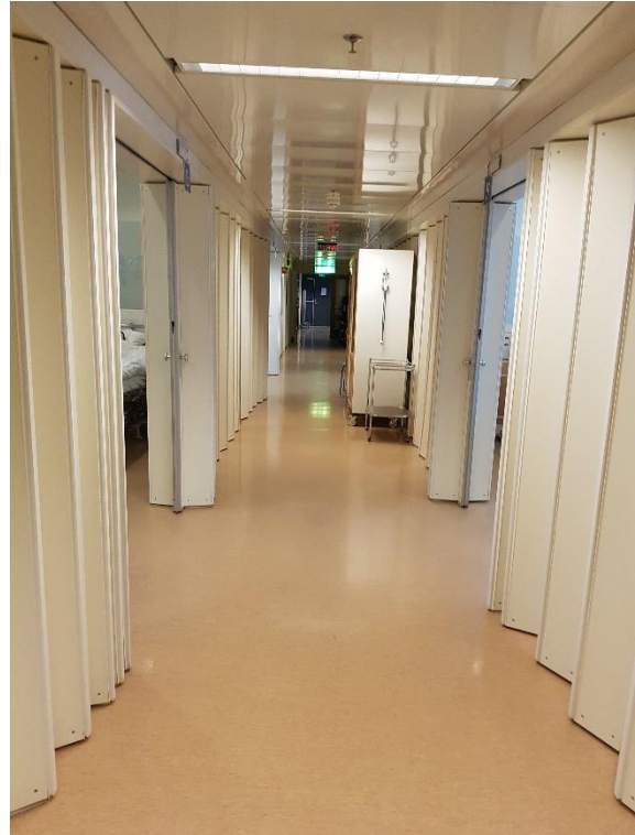
Figur 13. Gulvbelegget prøvetatt som P8 går igjen i store deler av bygg C.
