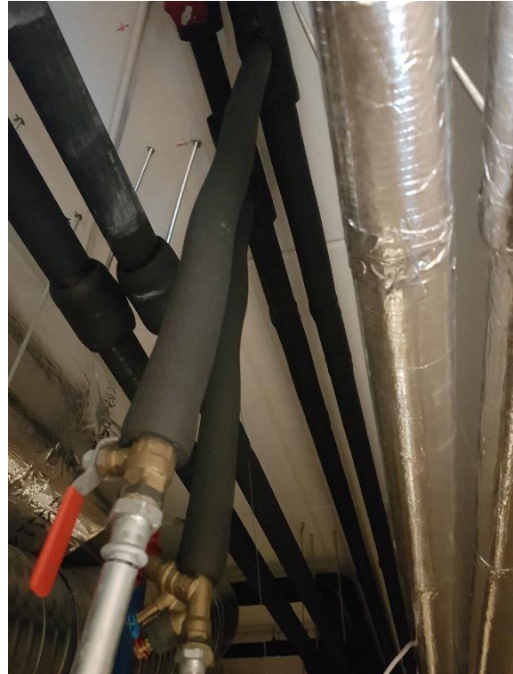
Figur 9. Cellegummiisolasjon som vil bli fjernet i forbindelse med rehabiliteringen.
