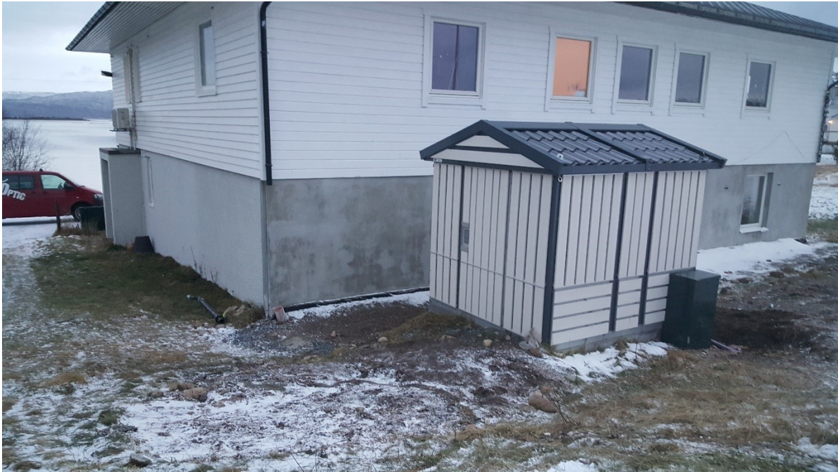
Bildet over viser Bredbåndsfylket sin node på Stonglandseidet utvendig.
