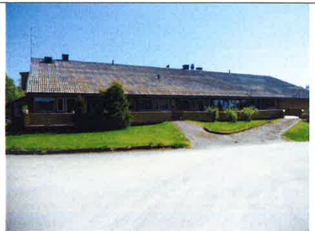
1984-bygget – 2. etasje, noe slitt takbelegg
