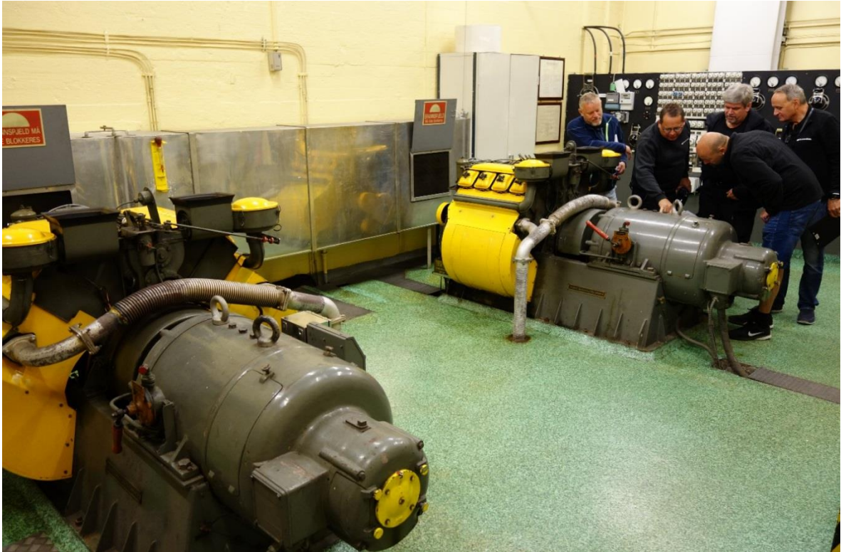
Bilde nr. 1: Eksist aggregater i maskinrom m. tilluftskammer til venstre og gml.hovedford. bak til høyre.
