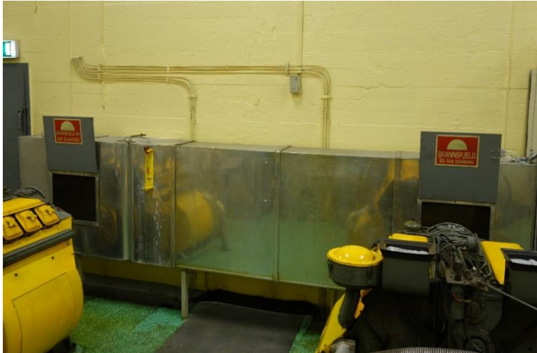
Bilde nr.5: Tilluftskammer forsynt via dagtank/batterirom.
