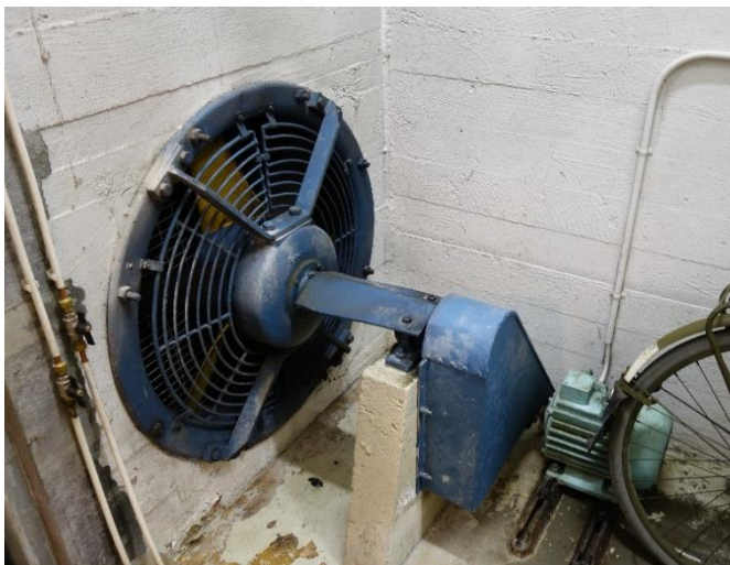
Bilde nr.6: Termostatstyrt tilleggsvifte tilluft i vegg mellom sjakt/kulvert og dagtank/batterirom.
