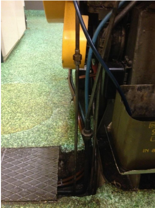
Bilde nr.3: Oppstikk til eksist. aggregat fra gulvgrube.
