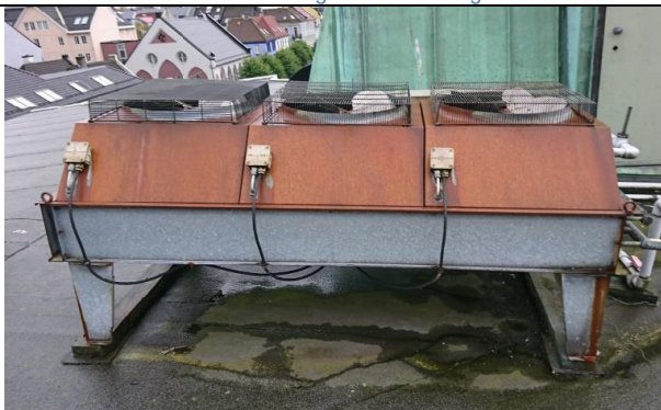
111 Kjølemaskin på tak
