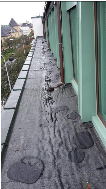
09 Gesims 1, deler av inspeksjonsvei utenfor 4. etasje. Se takplan for lokalisering. Ny oppbrett brettes opp langs vegg for etablering av nye beslag, iht. post. Oppbrett/tekkingg tekkes innunder nye gesimsbelag
